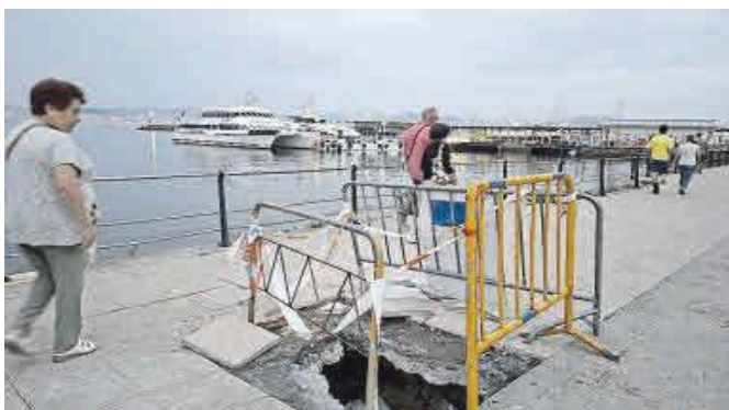
Socavón en el frente marítimo de Cangas.
